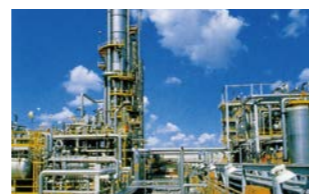
圧力用配管(プラント)
